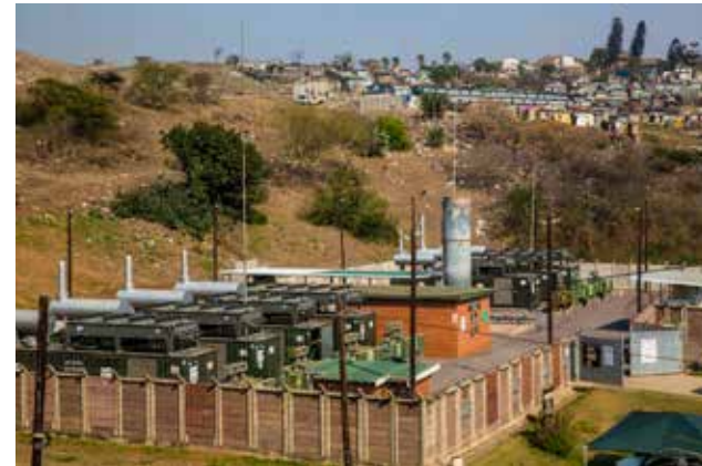
Figure 27 : vue générale de la centrale électrique de eThekweni, qui récupère le méthane formé par la fermentation des déchets et l'utilise pour produire de l'électricité. Durban, Afrique du Sud.
