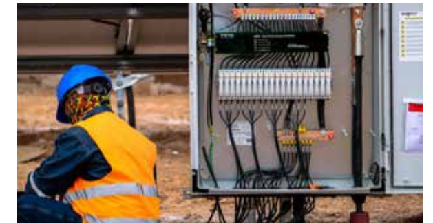
Figure 22 : installation de valorisation énergétique de déchets agroindustriels par processus de pyrolyse au sein du projet Agrovalor, Côte d'Ivoire. Crédit : Pablo Ramos Roncal/AFD
