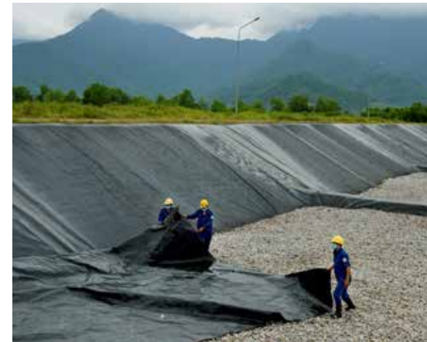
Figure 16 : installation de la bâche imperméable sur le nouveau casier du centre d'enfouissement technique de Lọc Thủy, Lăng Cô, Vietnam.
